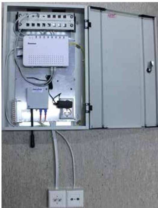
Kuva 4.25. Kotijakamon kaappi (Kuva ElmoNet Oy).
