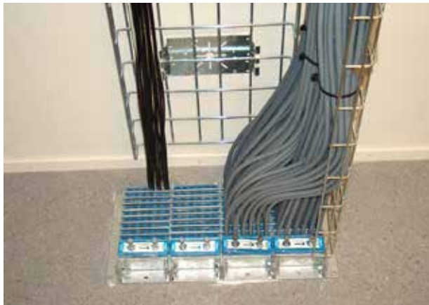
Kuva 8.22. Palokatko asettaa haasteita kaapeloinnille (Roxtec).
